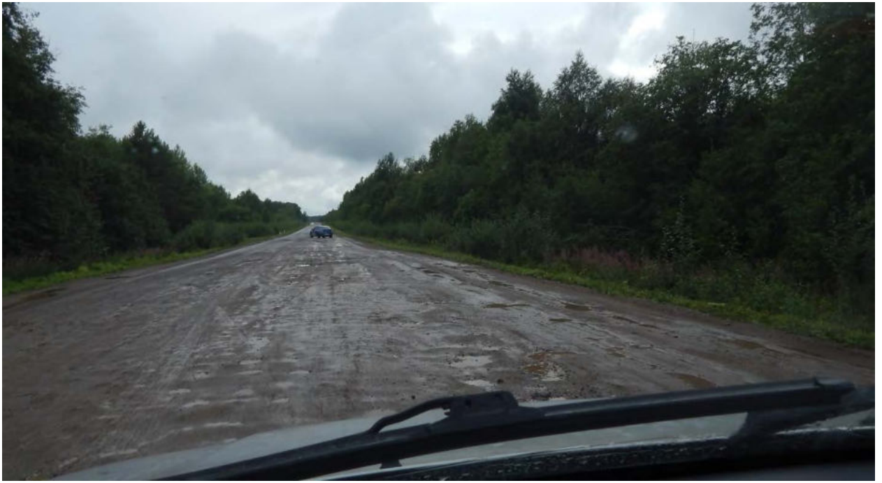
Фото 09.13. Проходим участок убитой дороги
