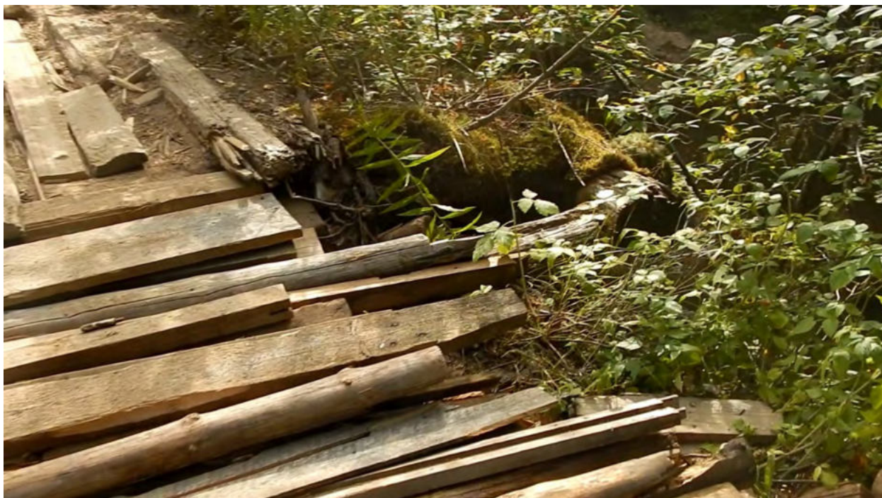
Фото 08.22. Справа и слева – сгнившие продольные и поперечные бревна, поросшие мхом, обвалившийся грунт рядом с опорами
