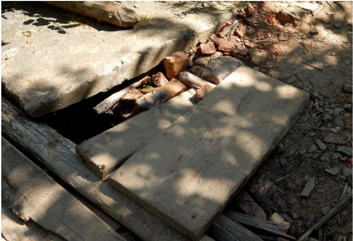
Фото 08.24. На выходе – дыры шириной в колесо
