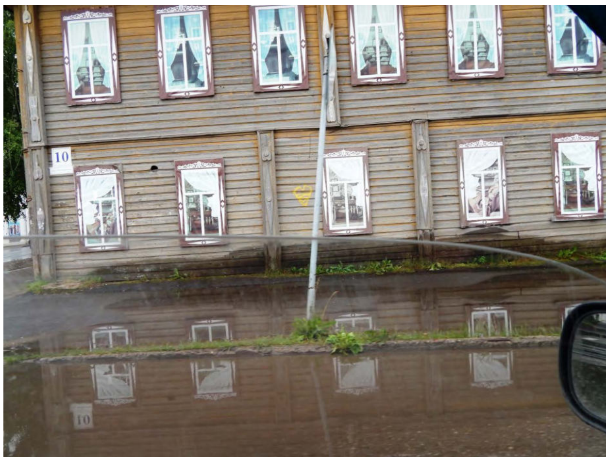
Фото 03.14. Увы, фундаменты деревянных домов мокнут во время дождя, вода не уходит
